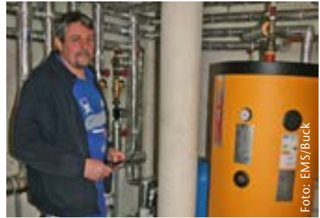
Rolf Bartel in einem der Heizungskeller
